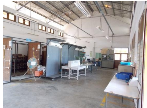
พื้นที่โรงฝึกงานช่างเครื่องปรับอากาศ
