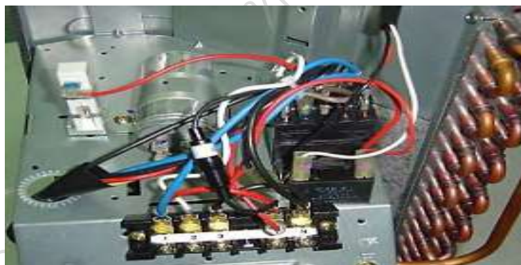
ภาพที่ 337 แสดงคาปาซิเตอร์ซึ่งติดตั้งในชุดคอนเดนซิ่งยูนิต
