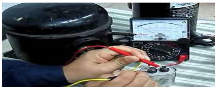
ภาพที่ 338 แสดงวิธีวัดสภาพและขั้วคาปาซิเตอร์รีน และ คาปาซิเตอร์สตาร์ทด้วย มัลติมิเตอร์วิธีการต่อ
