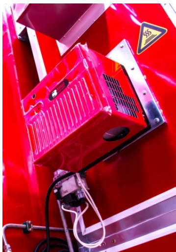
รูปที่ 2 ชุดแอดมเปอร์ปรับอากาศ
