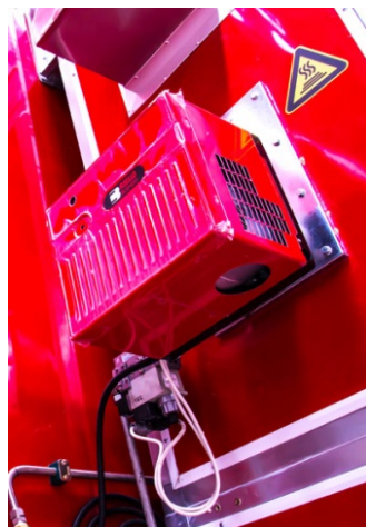
รูปที่ 12 ชุดแดมเปอร์ปรับอากาศ
