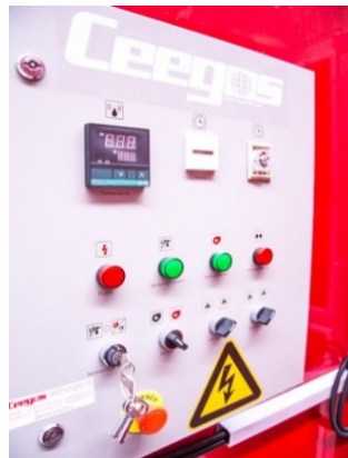
รูปที่ 1 แผงควบคุมการทำงาน
