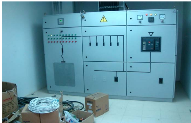
รูปที่ 12.2 กองวัสดุอุปกรณ์ต่างๆ วางกีดขวางหน้าตู้เมนสวิตช์
