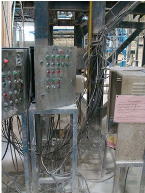
รูปที่ 12.4 การเดินสายที่แผงควบคุมไม่เหมาะสม (ไม่มีอุปกรณ์ป้องกันสายไฟฟ้า)
