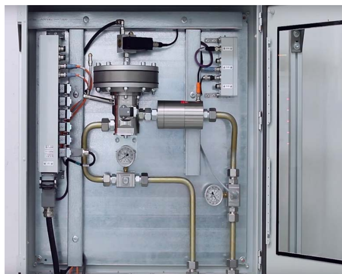
รูปที่ 8 แผงควบคุมการทำงานของระบบหมุนเวียนน้ำยาซีลเลอร์
