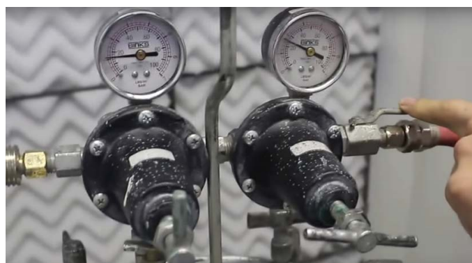
รูปที่ 5 ตัวควบคุมแรงดัน
