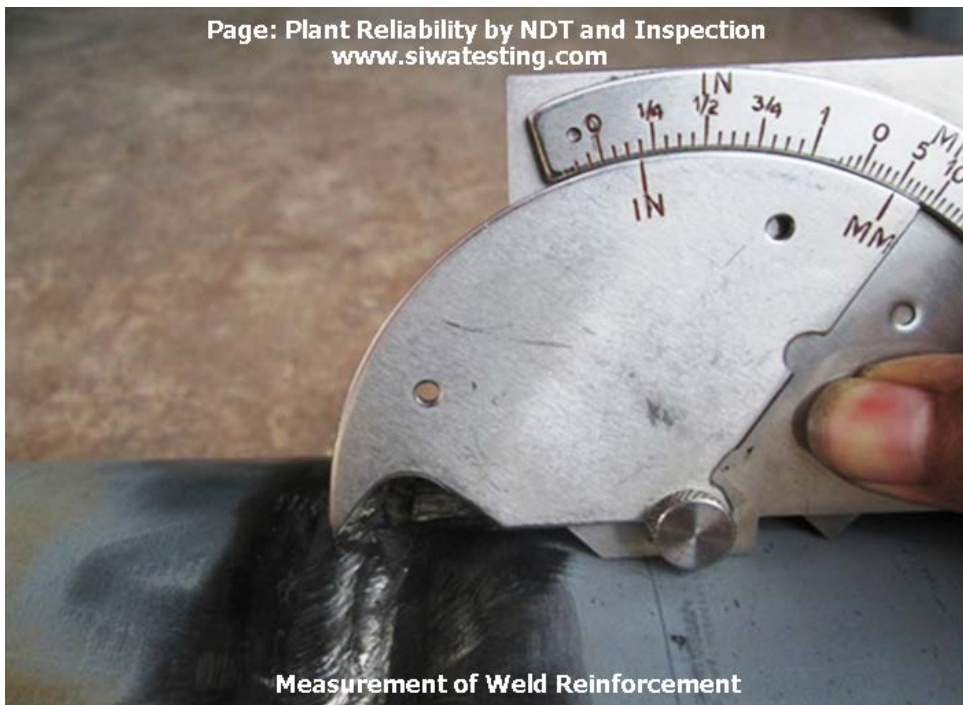
รูปที่ 6.19 ตัวอย่างการตรวจพินิจรอยเชื่อม ทำการวัดความหนาของรอยเชื่อมด้วยเกจวัดรอยเชื่อม (Measurement of weld reinforcement by a welding gage)
