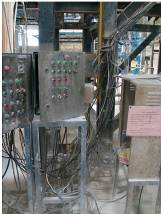
รูปที่ 4 การเดินสายที่แผงควบคุมไม่เหมาะสม (ไม่มีอุปกรณ์ป้องกันสายไฟฟ้า)
