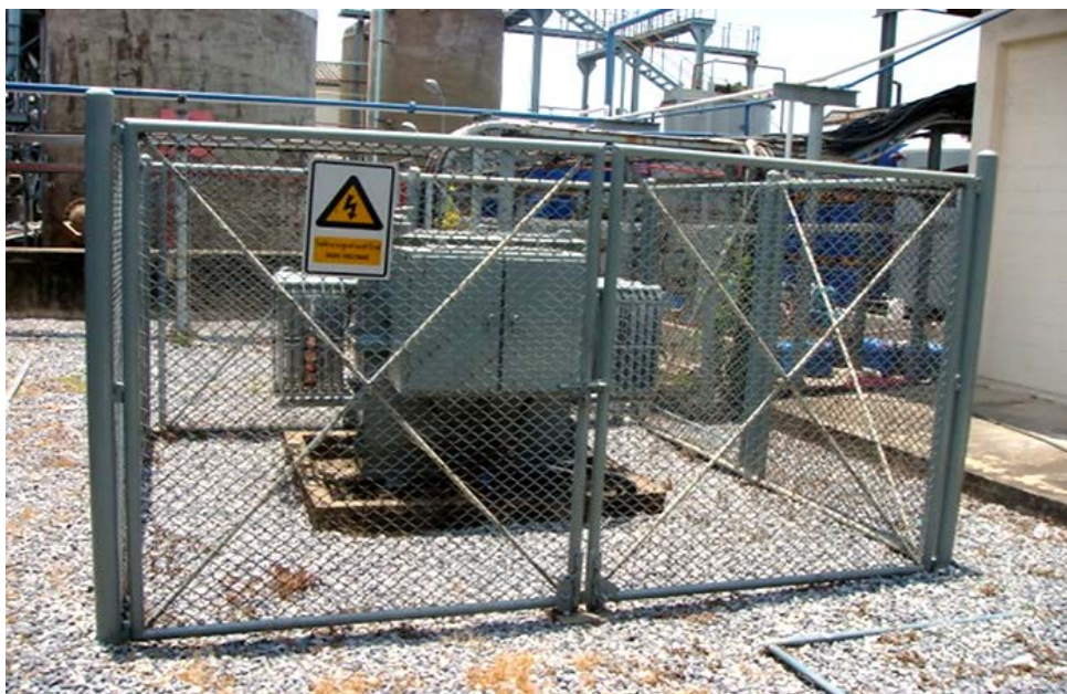
รูปที่ 1 ลานหม้อแปลงมีการโรยหิน มีรั้วกั้นบริเวณอันตราย มีป้ายเตือน
