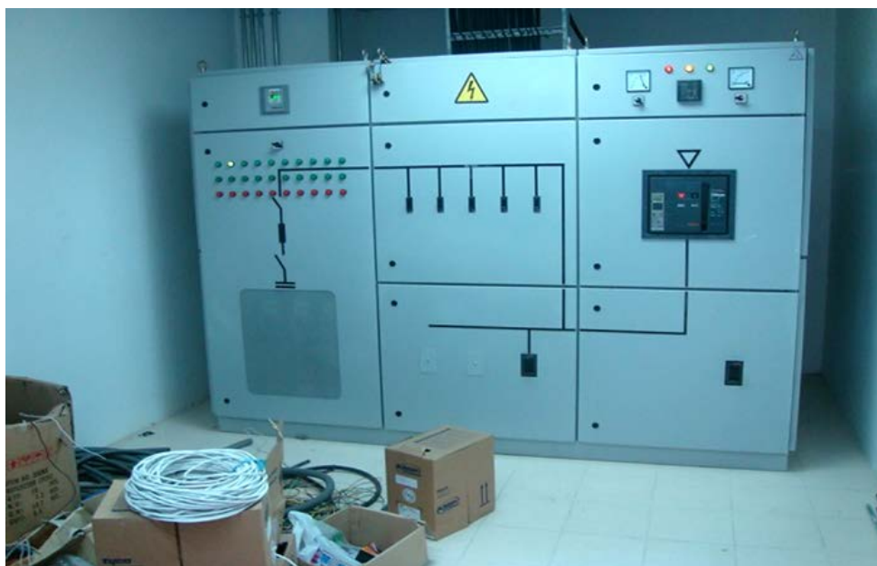
รูปที่ 2 กองวัสดุอุปกรณ์ต่างๆ วางกีดขวางหน้าตู้เมนสวิตช์
