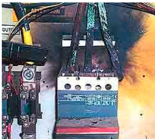
รูป 3 แสดงความเสียหายของจุดเชื่อมต่ออินพุตที่หลวมไม่แน่นของอินเวอร์เตอร์
