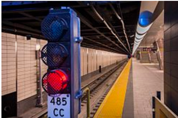
ระบบอาณัติสัญญาณ (Signalling)
