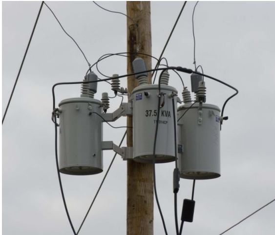
รูปที่ ๒.๓๔ หม้อแปลงไฟฟ้าแบบติดตั้งบนเสา
