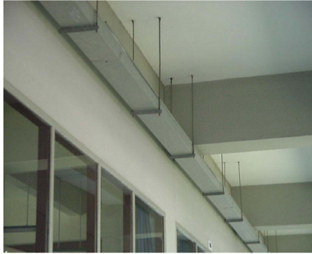
รูปที่ ๒.๔๗ การใช้รางเดินสายในงานติดตั้งระบบไฟฟ้า
